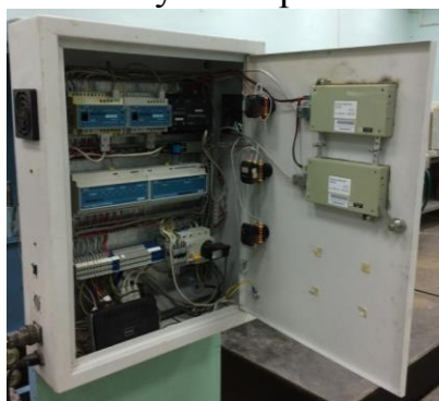
Рисунок 10. Внешний вид шкафа управления
